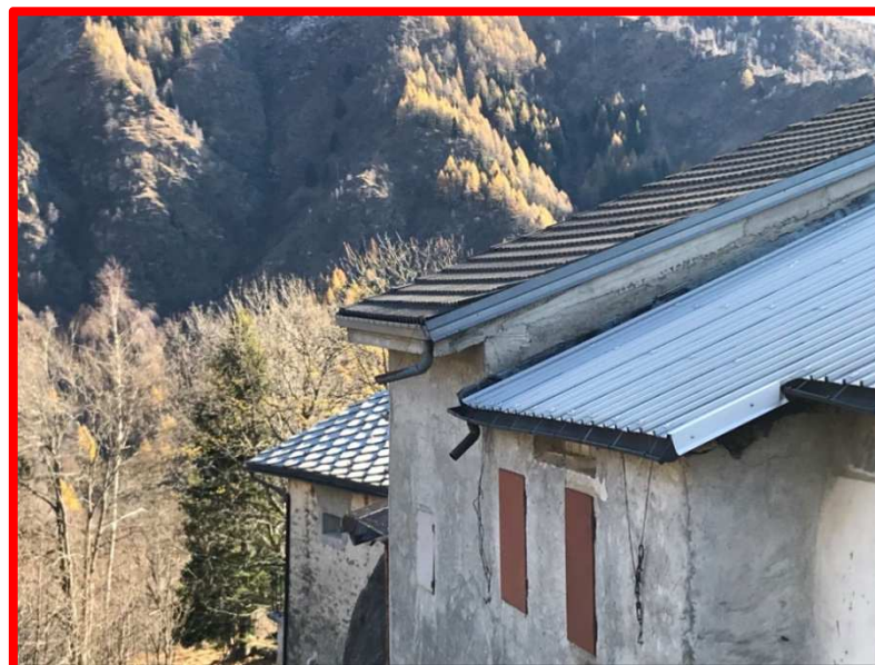
Figura 25: manto in lamiera grecata sconsigliato
