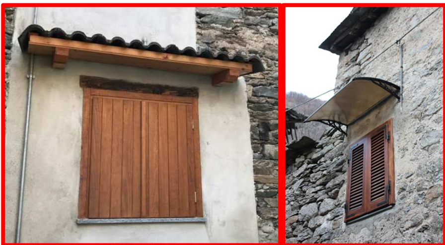
Figura 62 elementi di protezione non conformi alla tradizione costruttiva
