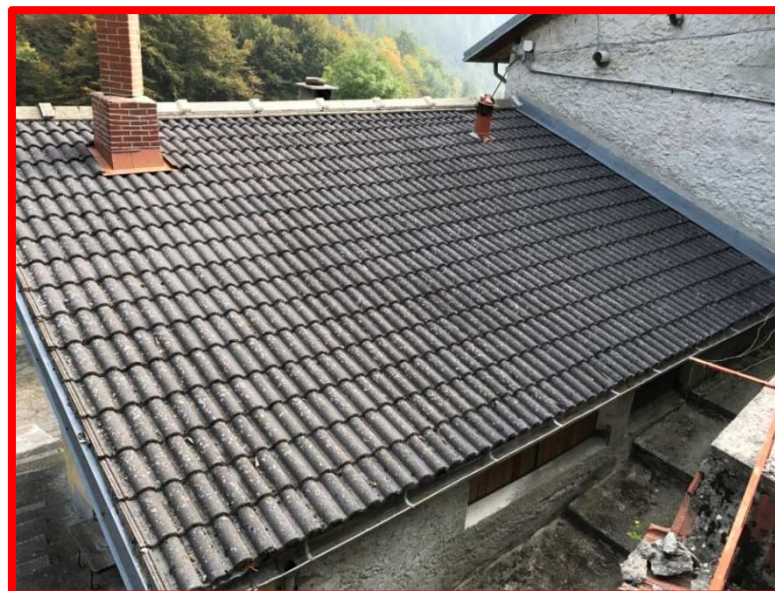
Figura 24: manto in laterocemento sconsigliato
