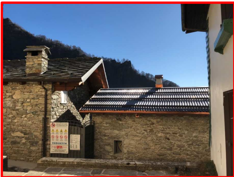
Figura 29: manto in lamiera grecata sconsigliato
