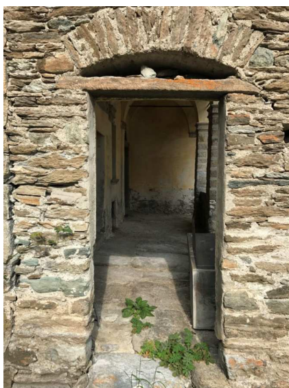
Figura 47: architrave e piattabanda in conci di pietra
